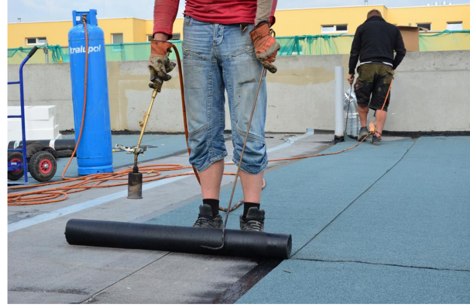
NATAVENÍ VRCHNÍHO HYDROIZOLAČNÍHO ASFALTOVÉHO PÁSU, TEPEM SE FINÁLNĚ AKTIVUJE SPODNÍ SAMOLEPICÍ PÁS
