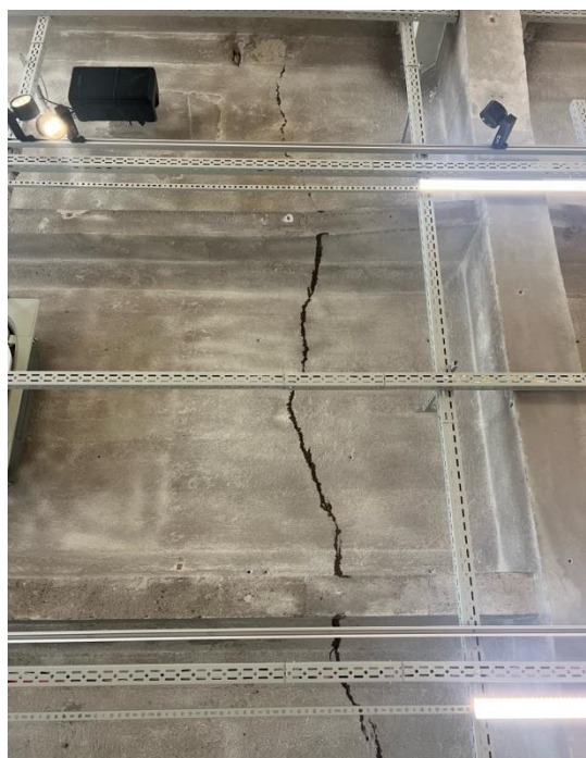
Obrázek10, Přiznané praskliny, které byly vyztuženy epoxidovanou pryskyřicí v hlavním výstavním prostoru, zdroj: autor
