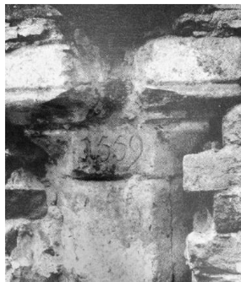
obr. 10 Detail postradalé hlavice pilíře 20
