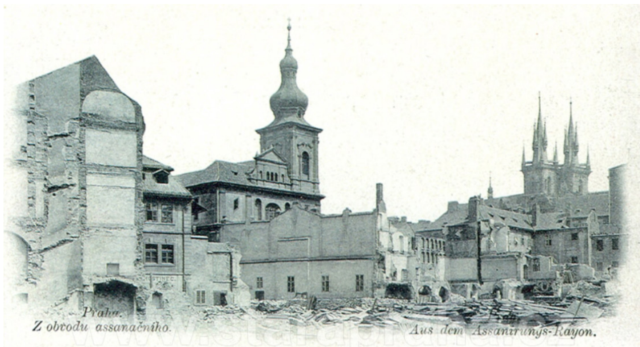
První demoliční etapa pražské asanace v letech 1896 - 1898 v dnešní Salvátorské ulici ( www.starapraha.cz/pohlednice-praha-asanace-josefov )
