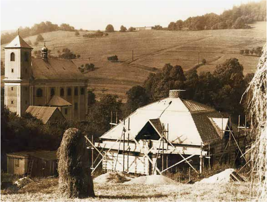
Roubenka v podhůří Hostýnských vrchů v Rajnochovicích, 1992-1993, výstavba (soukromý archiv Petra Hruší)
