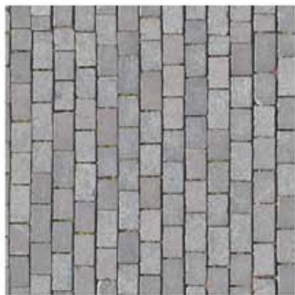
Kamená dlažba vozovky v pěší zoně.
