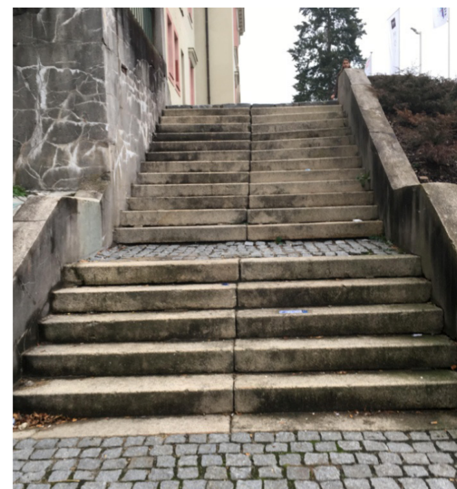
- schodiště v levé straně jsou špatně udržované - 18 schodů
