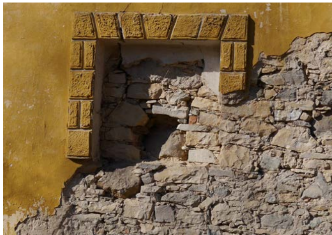
V16 Zdivo parapetu niky organicky provázané vylučuje dřívější existenci římsy, a tím potvrzuje spodní šambránu
