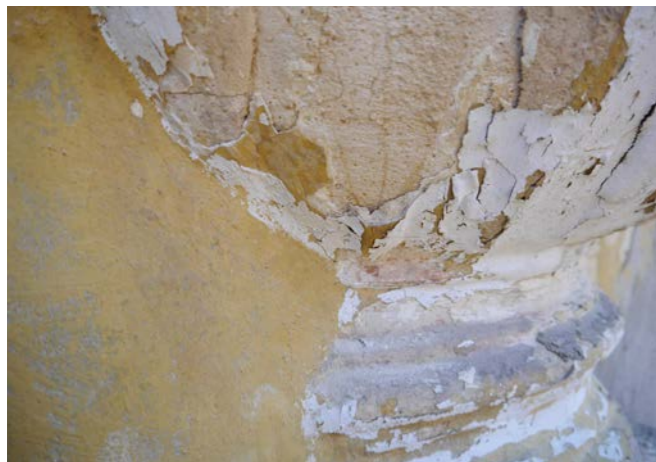
S14 Plynulý přechod základového nátěru plochy fasády a vázy, červený nátěr na profilaci vázy
