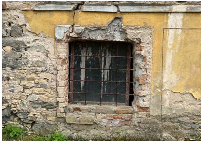
S7 Cihlová dozdivka naznačující dodatečné zvětšení okenního otvoru v přízemí
