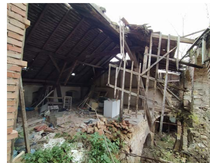
propadlý krov a podlaha v patře
