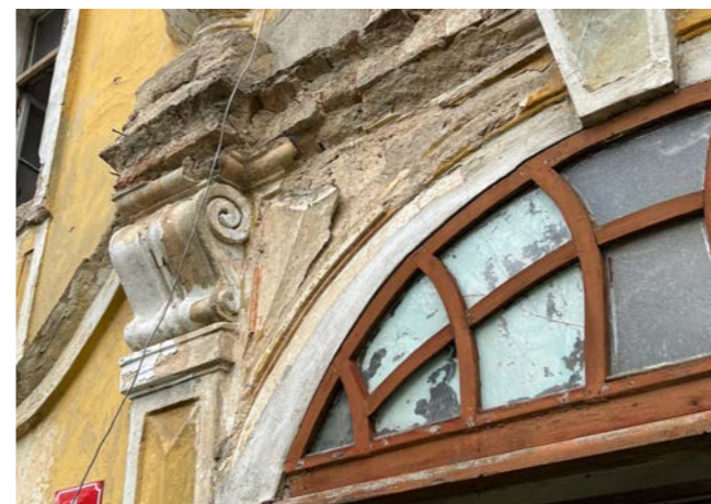
S13 Červený nátěr zdůrazňující plasticitu diamantování ve cviklu portálu; stratigrafická návaznost klenáku
