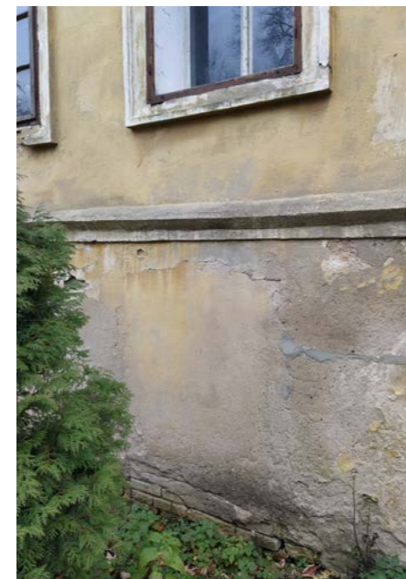
S18 Praskliny po obvodu zazdívký dveřního otvoru
