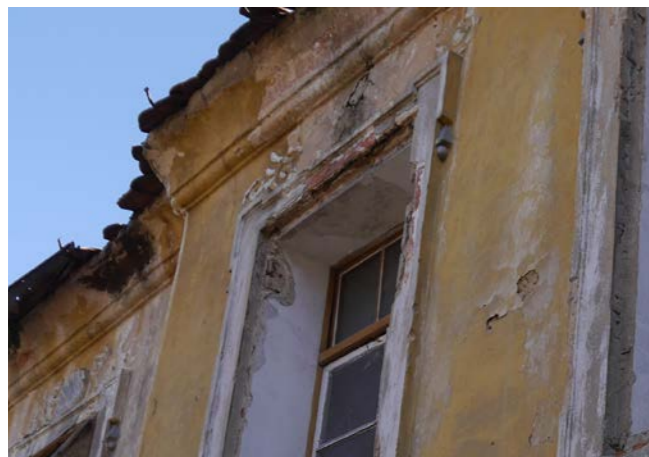
S10 Červený nátěr v šambráně okna
