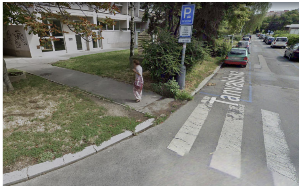
Přechody pro chodce ve špatném stavu, často bez signálních a varovných pásů, které mají být barevně a materiálově odlišeny.
