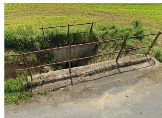
Obr.119:11 - další zatrubněný potok pod silnicí a zemědělskou půdou
