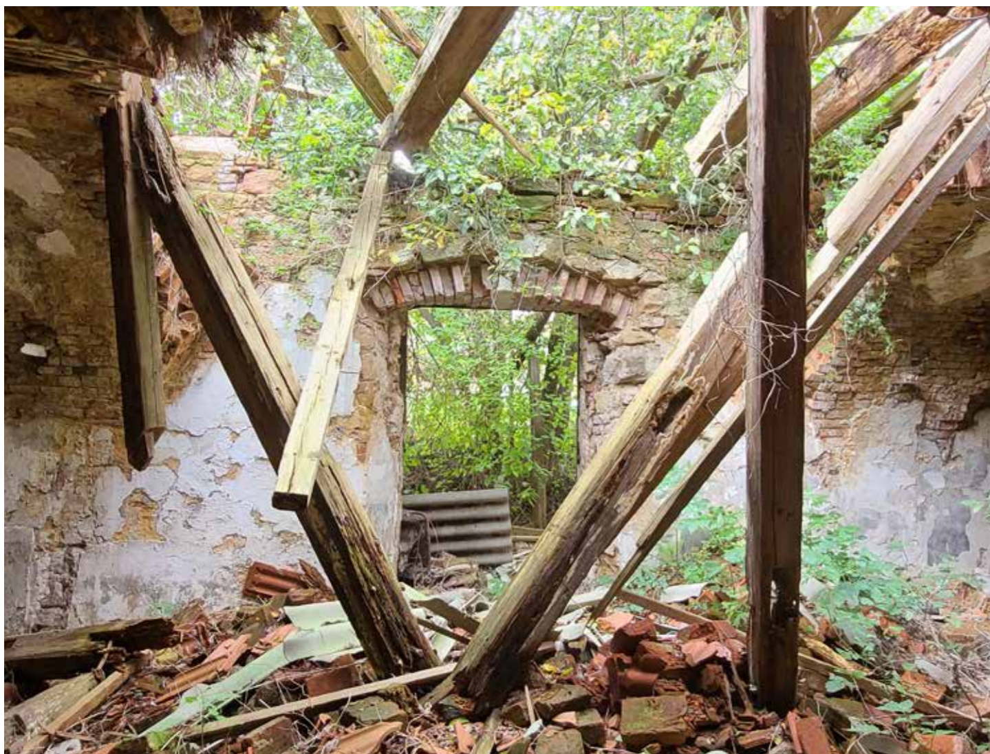
Propadá křížová klenba v severní části objektu
