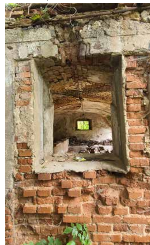
Exteriér probíhající spáry ve zdivu
