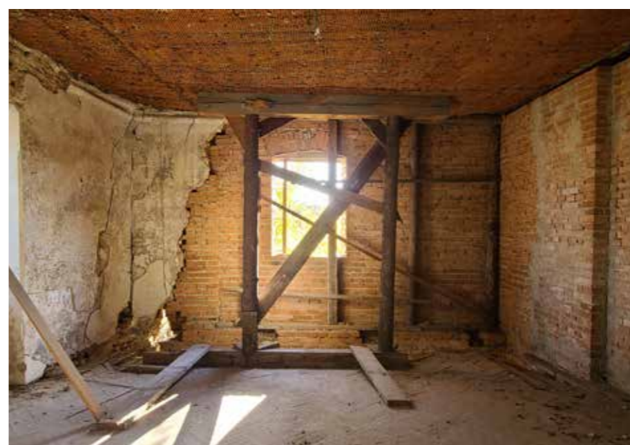
Jihovýchodní rohový pokoj se zřícenou podlahou v prvním patře
