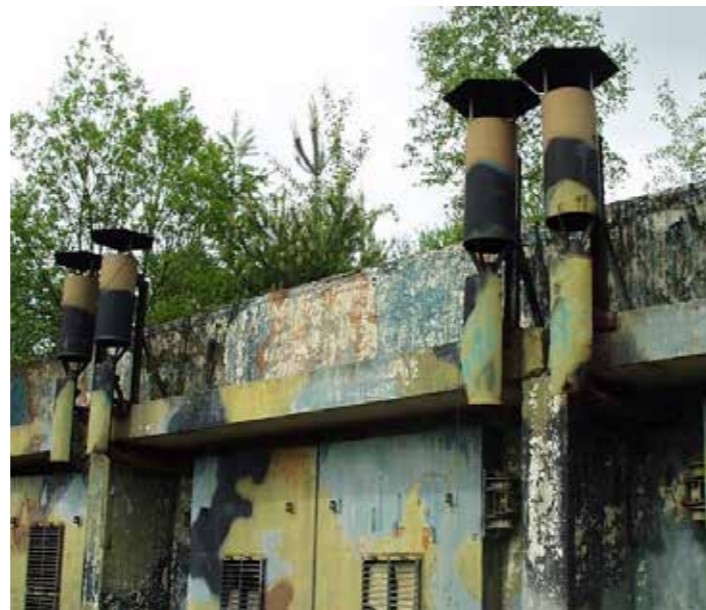
Výduchy kouřovodů elektrocentrál nad portály vjezdů
