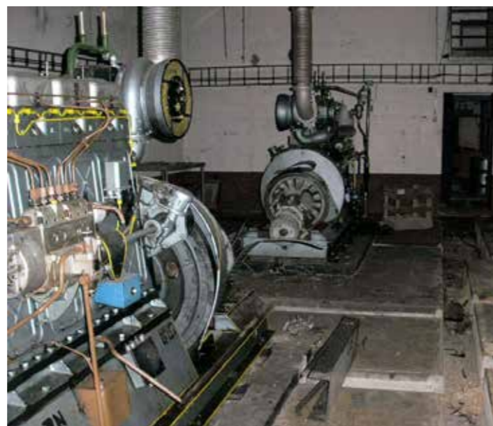
Místnost vlastní strojovny s dvojicí dieselaagregátů
