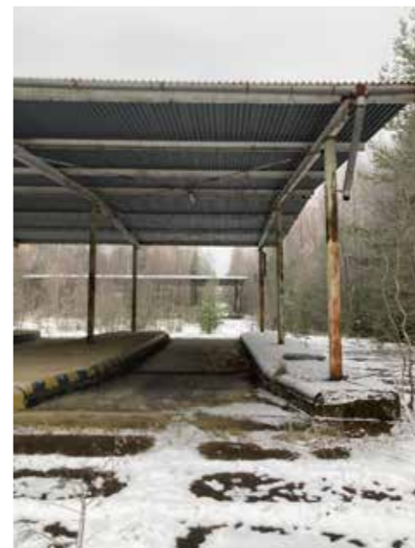
Průjezdni linka pro plnění raket palivem
