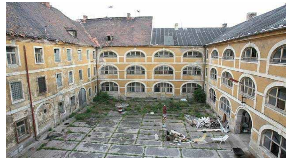
Dnes chátrající Žižkovy kasárny Terežínského brownfieldu
