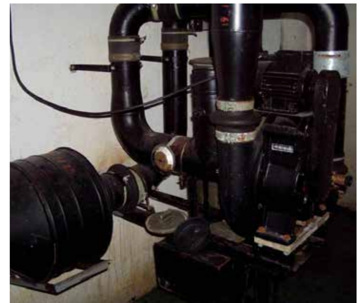
Filtroventilace uvnitř úkrytu
