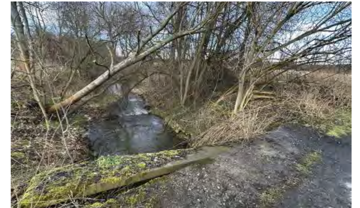
Rozpadávající se betonový můstek přes potok (4.)
