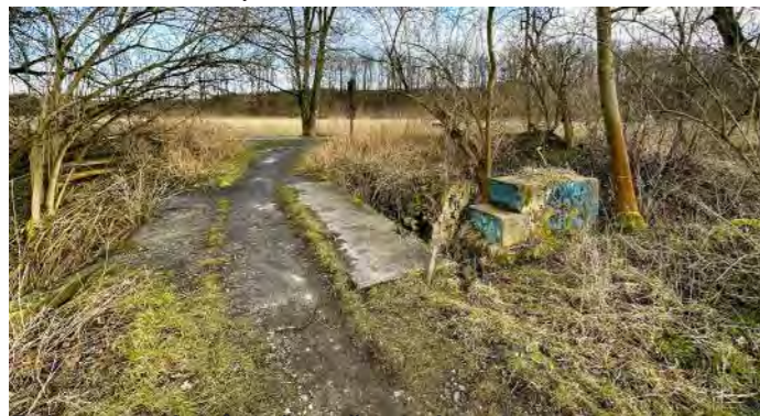
3. betonový můstek ve špatném stavu
