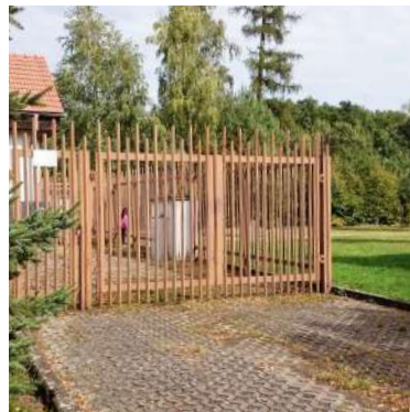
Obr. 21 Stávající zrezivělé oplocení u rozhledny na Chlumu
