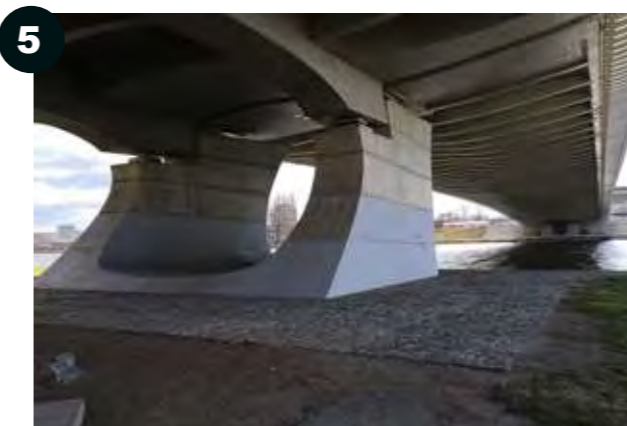
Obr.č. 124 Stav pod Trojským mostem, zdroj vlastní 2023
