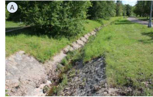
obr. 90: betonové koryto trativodu na východním okraji lesoparku vlastní foto
