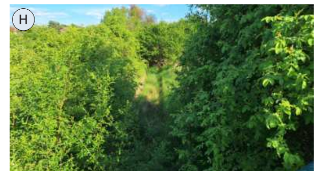
obr. 97: Zcela zarostlé betonové koryto poblíž prameniště vlastní foto
