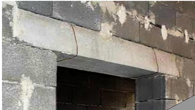
Železobetonové monolitické překlady
